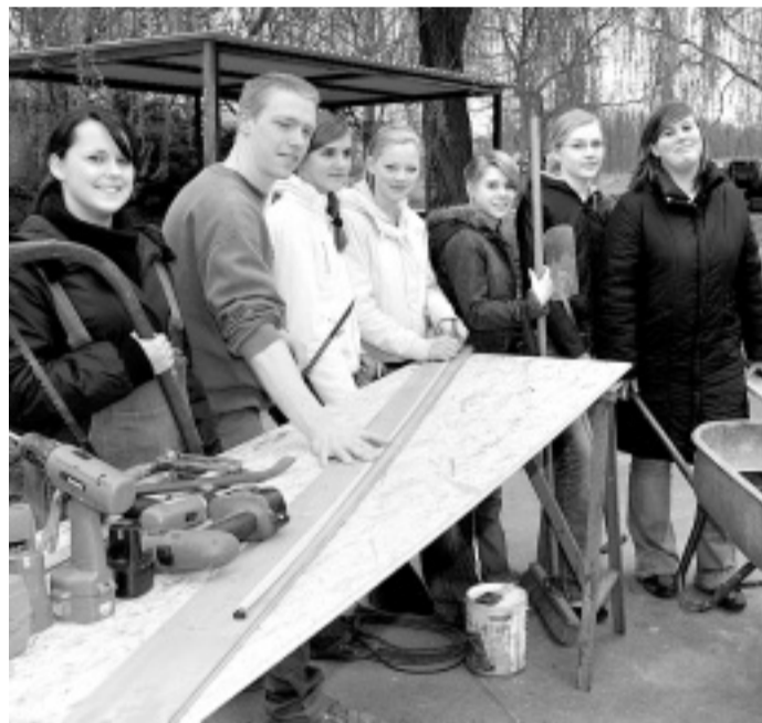
Mit Bohrer und Säge am Werk: Liza Stücken, Jakob Heining, Melanie Metzger, Sabine Wullmann, Jacqueline Graf, Renata Böttcher und Siria Grasekamp (v. l.) vor ihrem neuen Schutzhäuschen. FOTO: SCHLÜTTER
