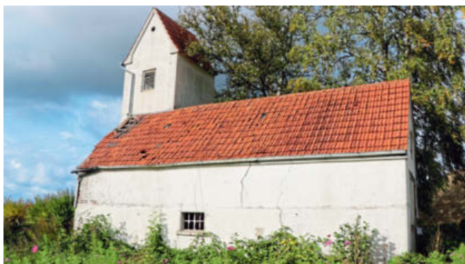
Das Spritzenhaus in Lenzinghausen wird seit vielen Jahren nicht mehr genutzt. Foto: Ekkehard Wind
