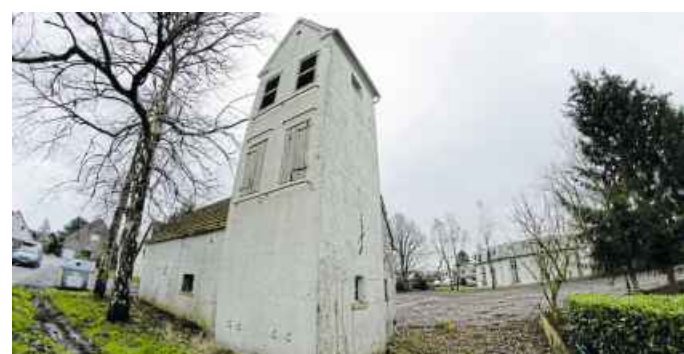
Bislang stand ein altes Spritzenhaus auf dem Gelände in Lenzinghausen, wo nun der Neubau der Kita entstehen soll. Das Spritzenhaus ist inzwischen abgerissen.
